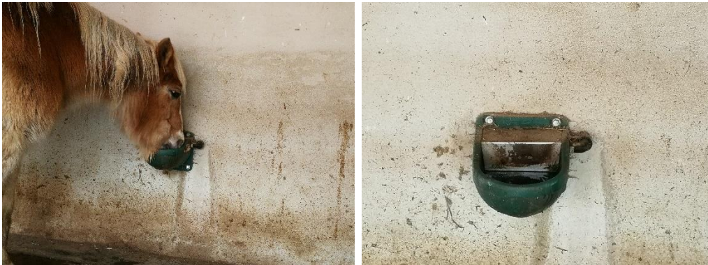
Abbildung 1: Pferdetränke direkt angeschlossen an die Trinkwasser-Installation, Quelle Kiefer
